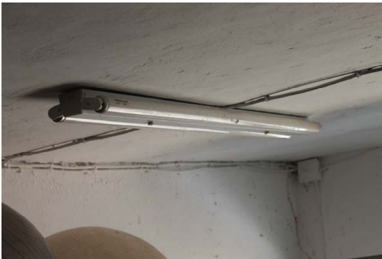
INSTALACION ELECTRICA ACTUAL
