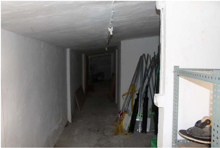
HUMEDADES MURO TRASERO
